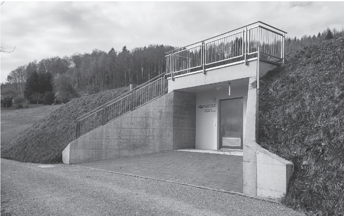
Das neue Reservoir und Pumpwerk Lochmatt Säriswil wurde im April 2019 in Betrieb genommen. Es ist mit neuster Technik ausgestattet und wichtig für die Versorgungssicherheit der Gemeinde Wohlen.
