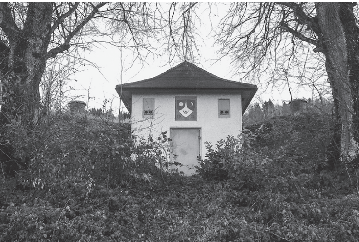
Das ehemalige Reservoir Neuhaus Säriswil lieferte von 1925 bis 2019 Trinkwasser. Bis 2006 gehörte es der Gemeinde Wohlen, ab 2007 dem WVRB. Die Anlage würde die heutigen Anforderungen nicht mehr erfüllen und wurde abgebrochen.
