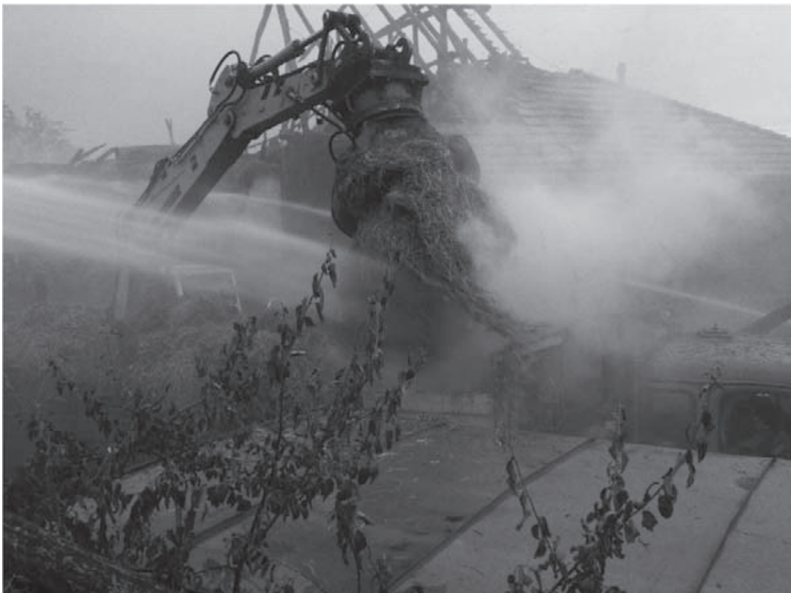
Brand Schüpfenried, Uettligen: Ein brennender Heustock kann kaum gelöscht werden. Er muss abgetragen werden.
