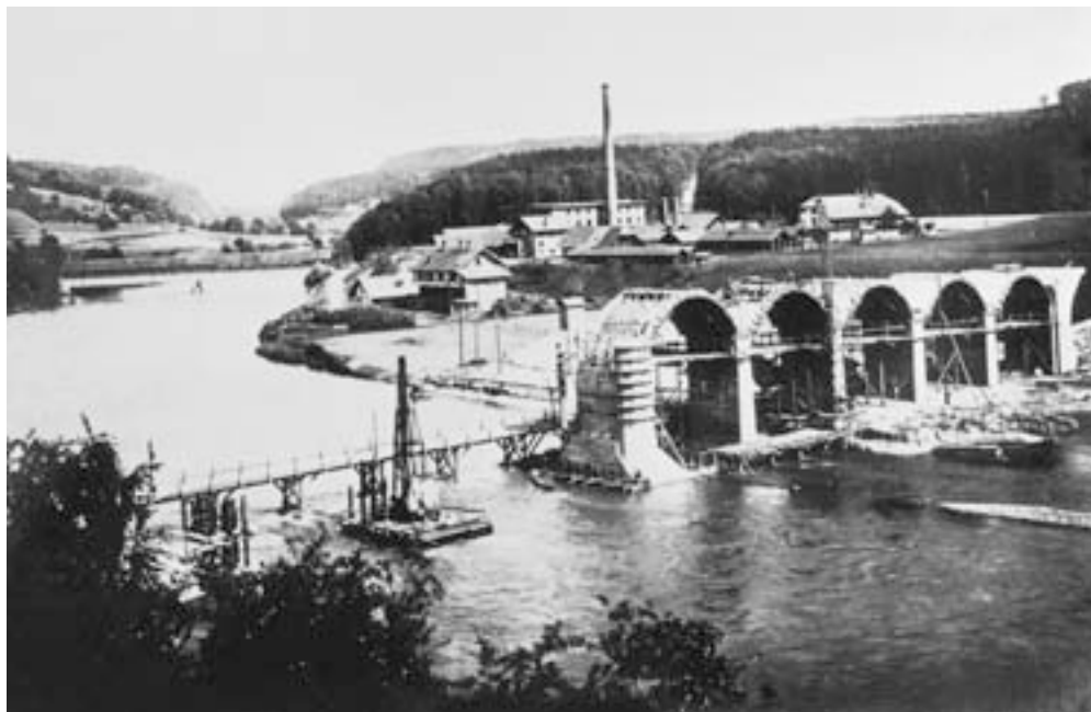
Die neue Hinterkappelenbrücke im Bau um 1918. Im Hintergrund sind die alte Ziegelei in der Eymatt und die alte Kappelenbrücke zu sehen
