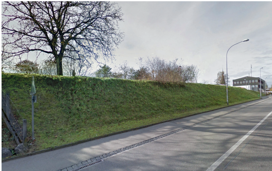
Abb. 3 Die Böschung entlang der Kantonsstrasse von Nordosten her gesehen; im Hintergrund rechts die Gemeindeverwaltung
