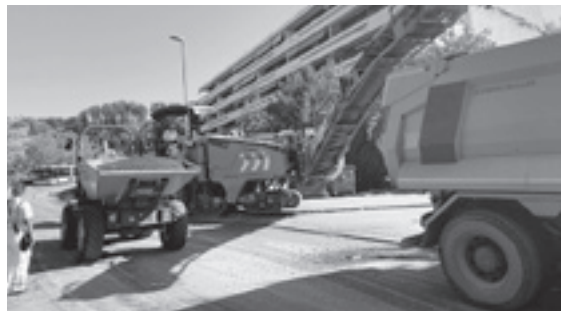
Nach dem Einbau der Fernwärme- und Wasserversorgungsleitungen 2019 erhält die Kappelenringstrasse auf rund 1100 Metern Länge einen neuen Belag. (Foto: Barbara Bircher)
